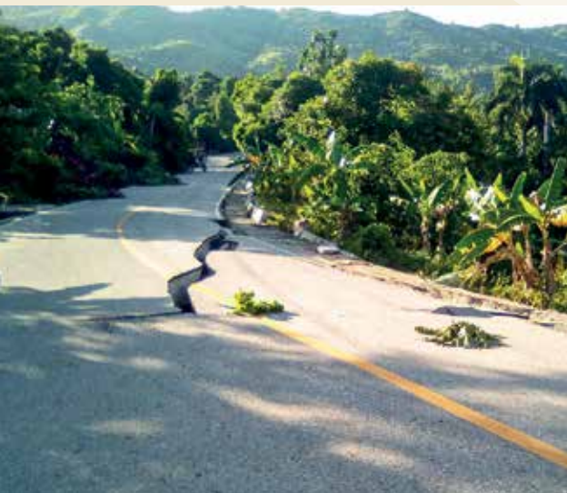
Das Erdbeben zerstörte Straßen und schnitt Landesteile von der Versorgung ab
